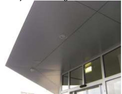
Außenbereich - LED Downlight 12x1 Watt mit Bewegungsmelder
