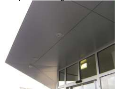
Außenbereich - LED Downlight 12x1 Watt mit Bewegungsmelder
